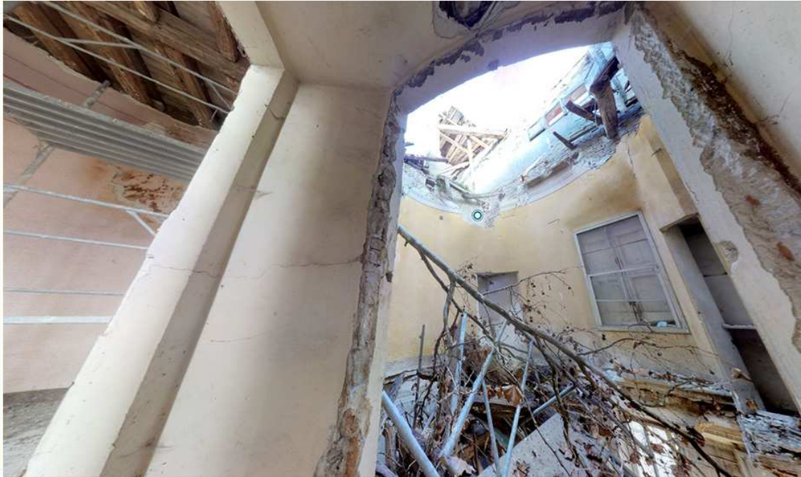
Figura 3 – Crollo porzione di solaio di piano primo e secondo.
