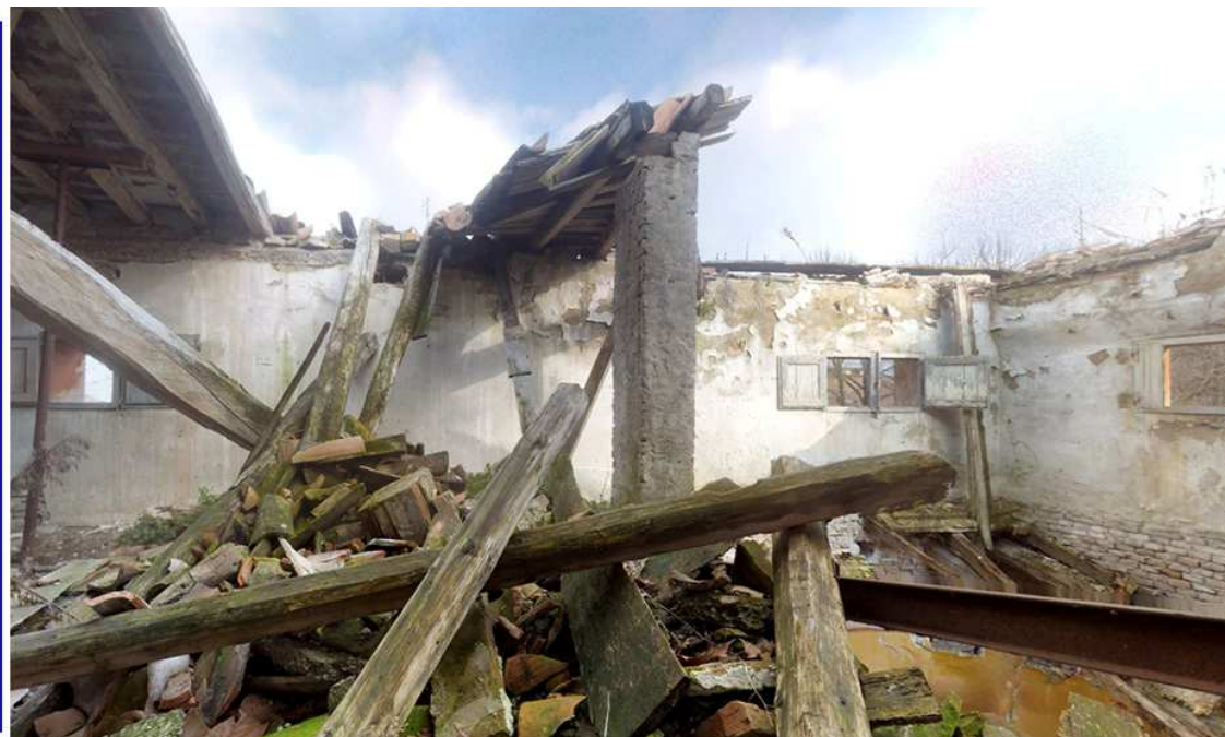
Figura 4 – Crollo porzione di copertura.
